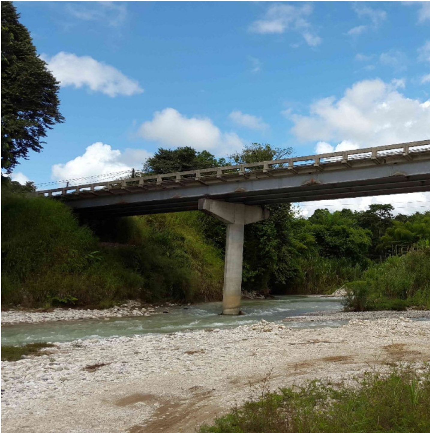
Puente sobre río Lagarto que se ubica en la ruta primaria número 2, en el cantón de Golfito. Fotografía tomada cortesía de Nazareth, tomada del Sistema de Administración de Estructuras de Puentes.
