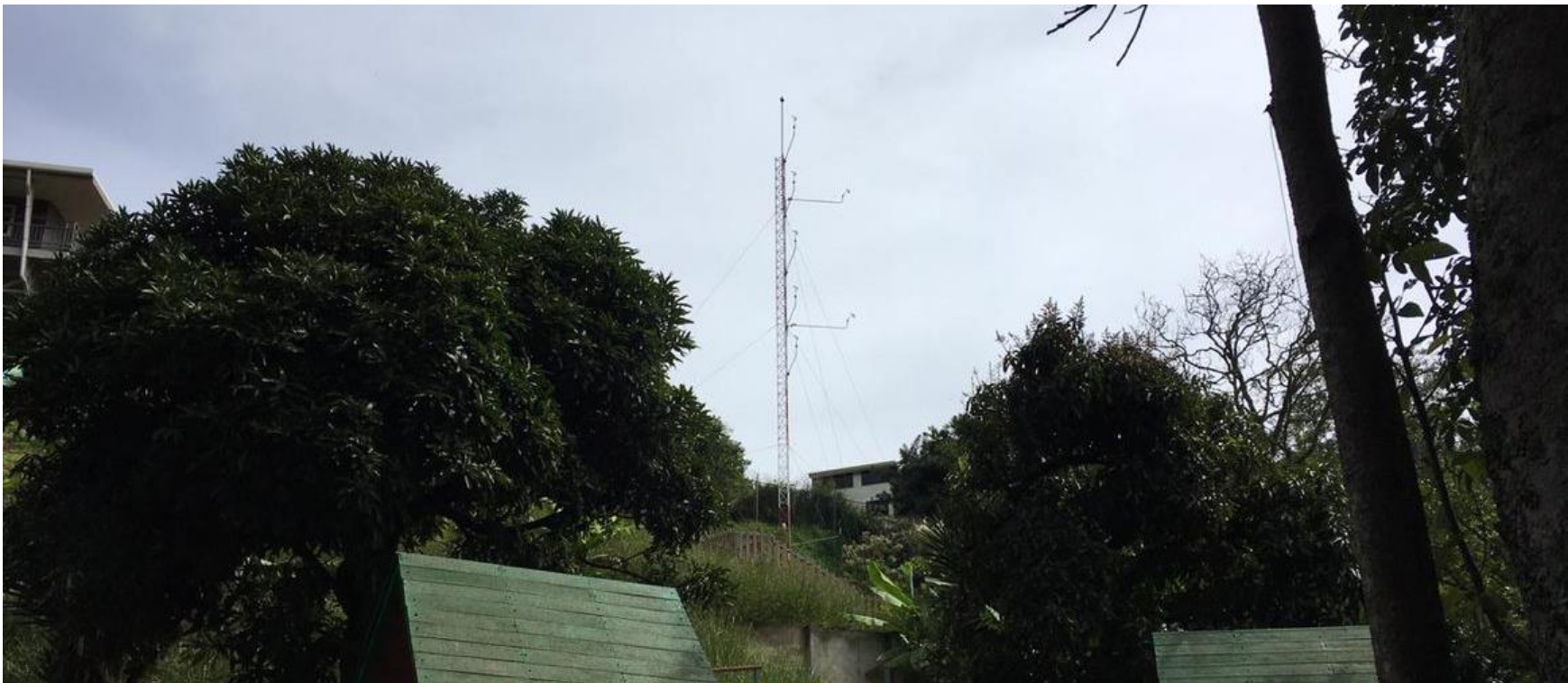
Figura 1. Torre de pararrayos instrumentada con anemómetros y veletas.
