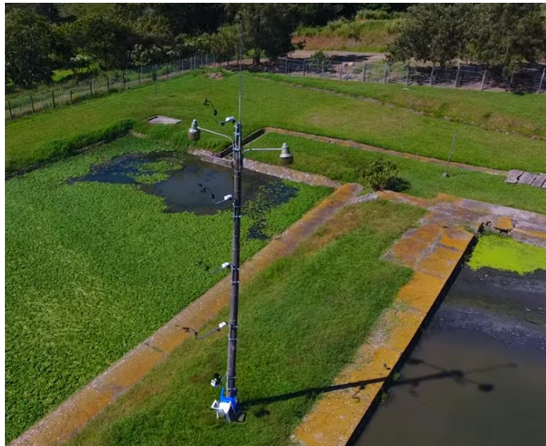
Figura 1. Torre meteorológica en la planta de tratamiento 1 .
